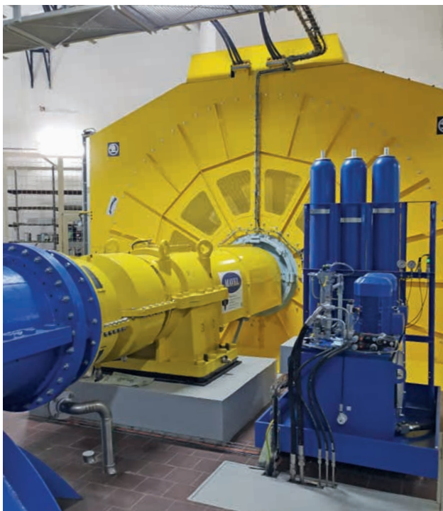
MVE Štvanice, turbína (autor: Hubalová Petra)
