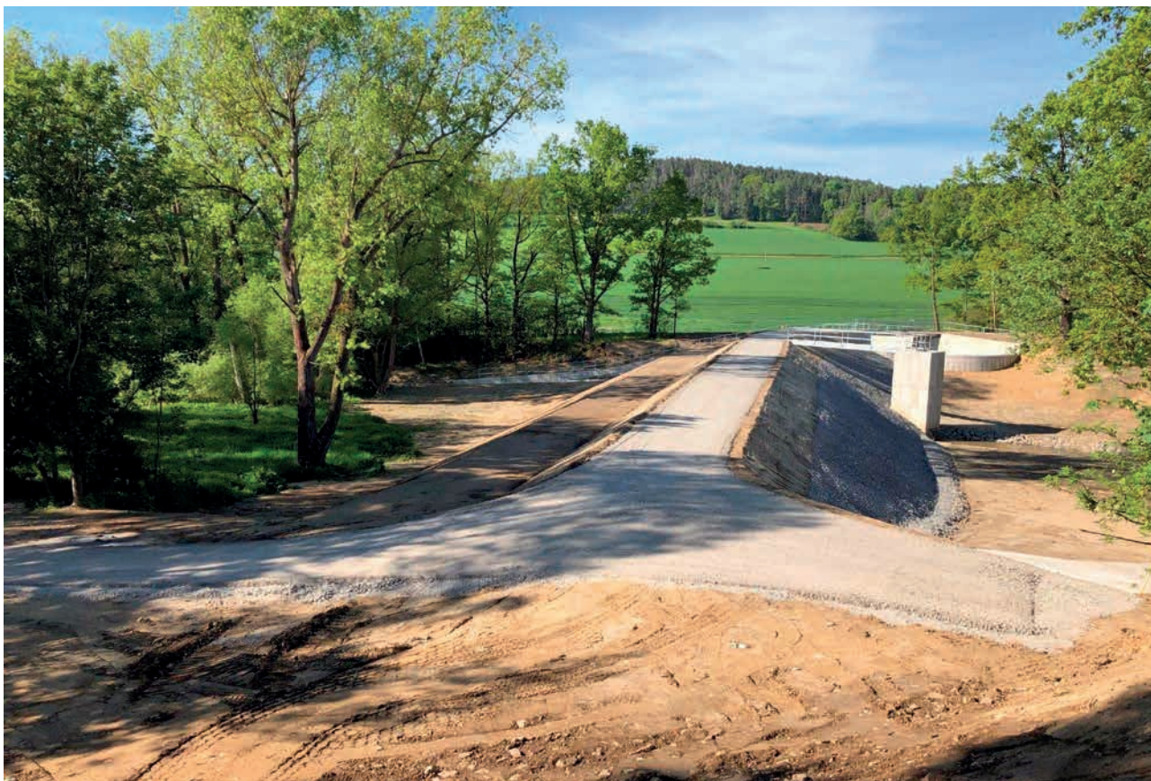
Bavorovský potok, MVN Přehrada Bavorov – rekonstrukce nádrže a odbahnění nádrže – stav po opravě (autor: Bušek Jan)
