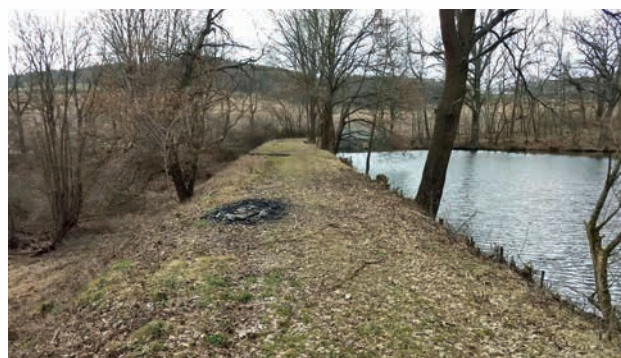
Bavorský potok, MVN Přehrada Bavorov – rekonstrukce nádrže a odbahnění nádrže, stav před opravou (autor: Bušek Jan)
