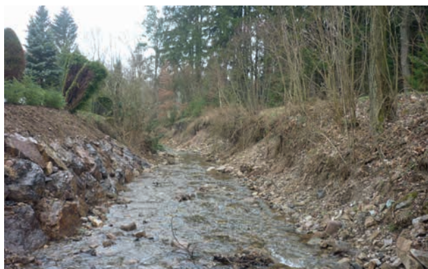
DVT Mourový potok, Zaječov – stabilizace koryta, stav před opravou (autor: Žáčková Anna)
